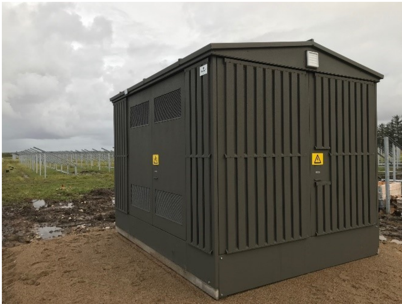
Eksempel på transformerkiosk.
